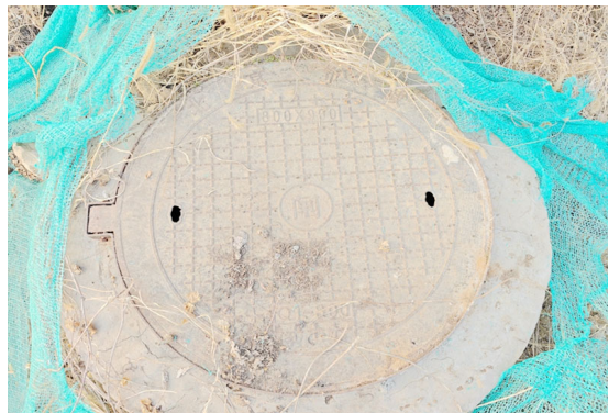
项目内上水检修井
