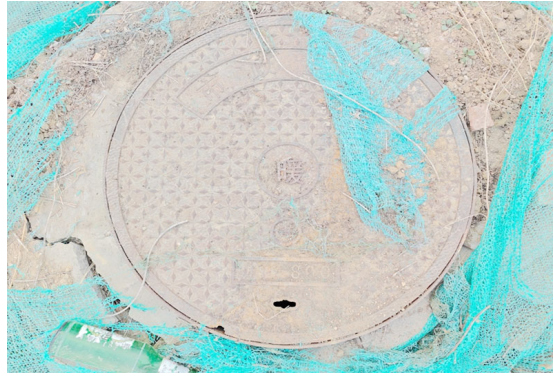
项目内热力检修井
