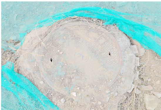
项目内燃气检修井
